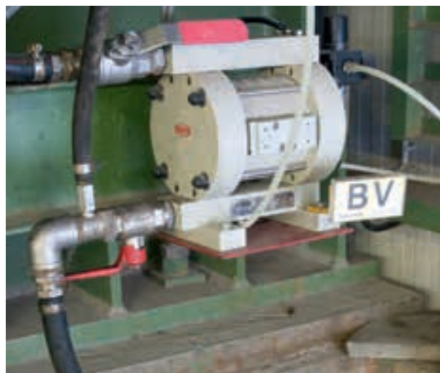
RFM: Pompaggio di additivi per cemento da IBC a torre di miscelazione.
