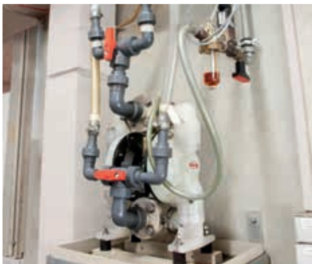
FDM: Pompaggio di nickel chimico su impianto galvanico.
