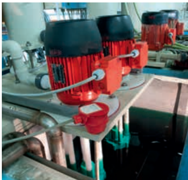
F 716 - Pompa di ricircolo in un bagno galvanico.
